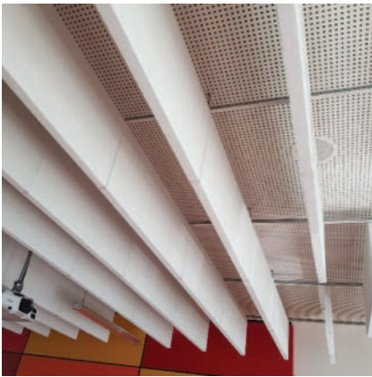
Abb. 4: Baffeln zur Lärmdämmung.
